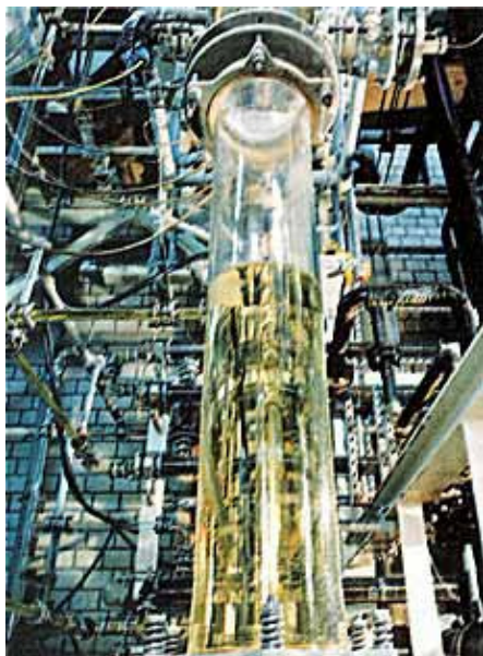
Eisenchlorid-Lösung aus der Oberhausener Anlage kommt bei der Aufbereitung von Abwasser wieder zum Einsatz.
